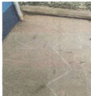
Foto 8: Torta de concreto
